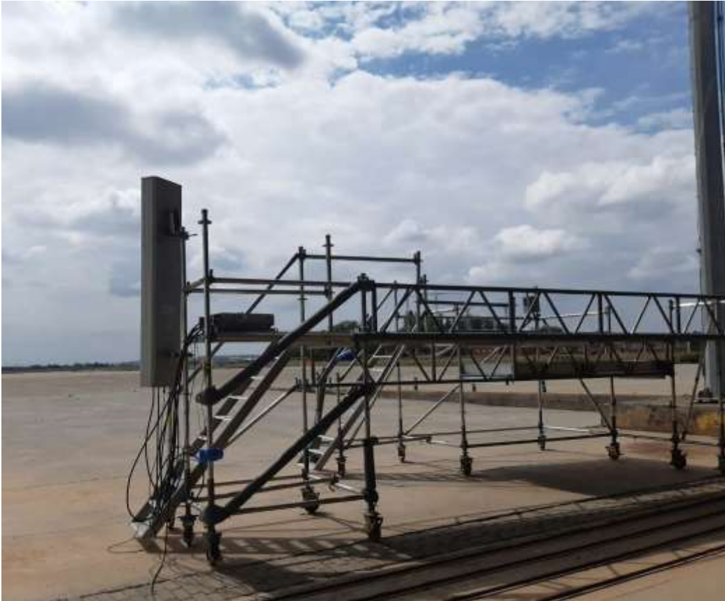
Figura 7. Detalle de la Instalación de la antena 5G para el ensayo
